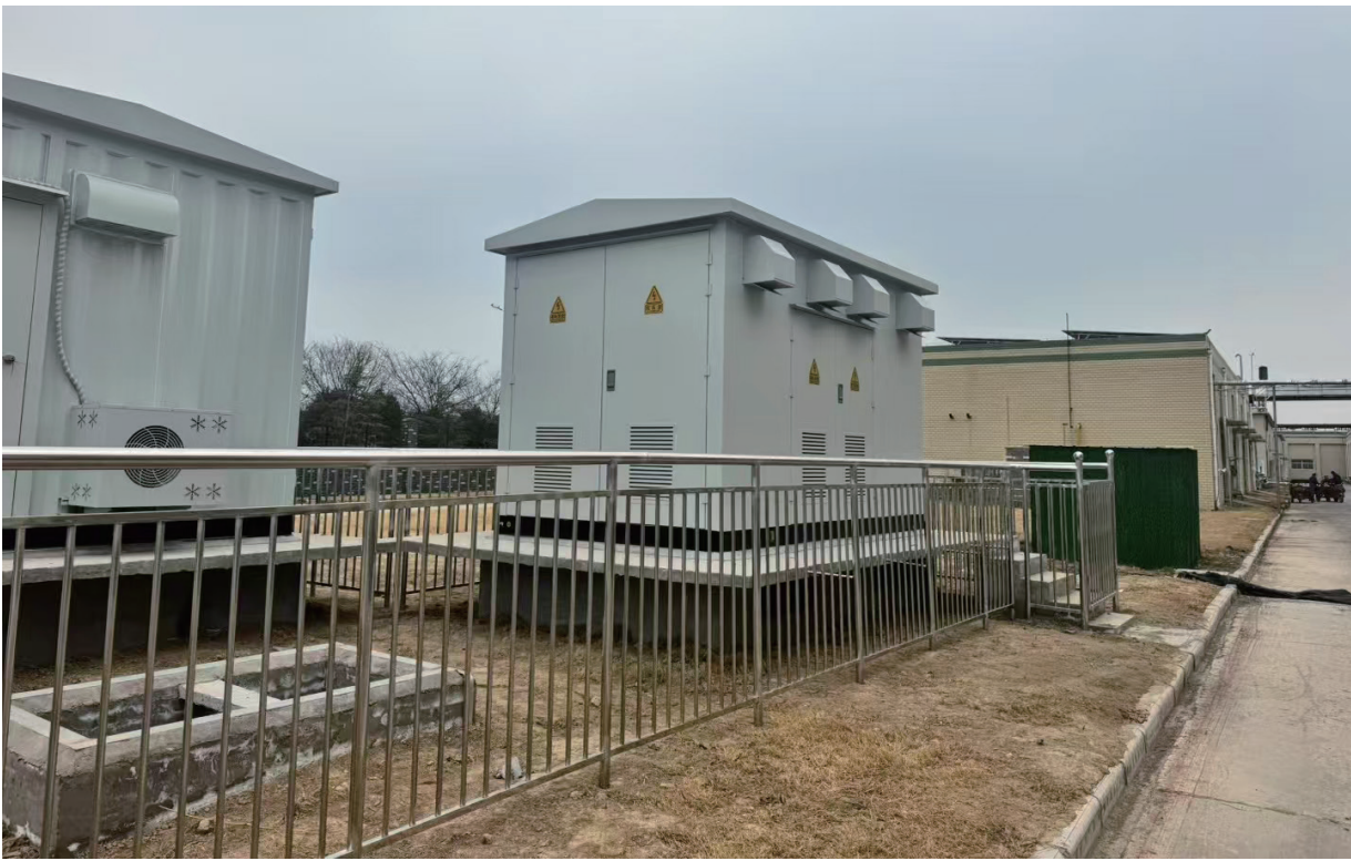
▲扬电电气储能电站。 扬中市融媒体中心供图
