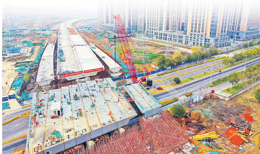
10日,南京机场二通道雨花台区段施工现场一片繁忙,工人正抢抓有利天气加快建设。南京机场二通道线路全长40公里,预计雨花台区段一期工程6公里多将于9月底通车,建成后有效改善这一片区交通状况。
